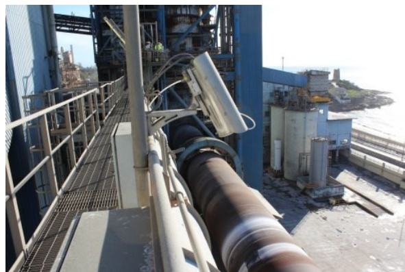
Sistema RKS300 operativo en planta de cemento
